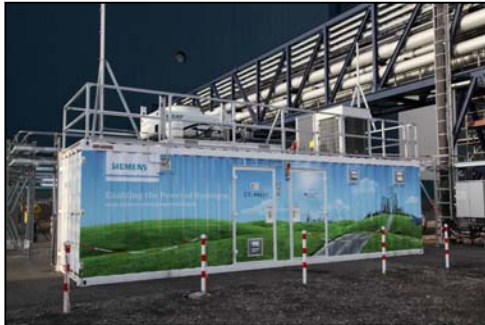
300 kW-PEM Electrolyzer (Siemens) at RWE site Niederaußem
